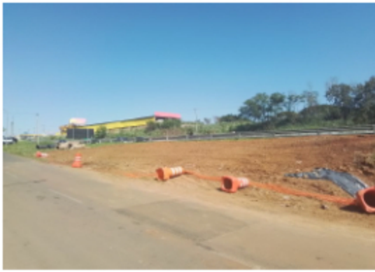
Foto 1 - Recomposição e erosão
